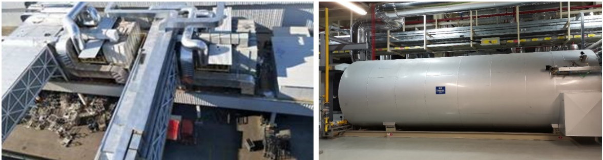
福特工厂的废气处理设施
